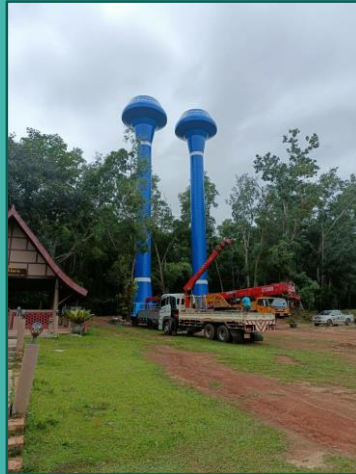
หอถังสูง ข้างศาลพ่อปู่โป่งลาน ความจุรวม 600 ลบ.ม.
