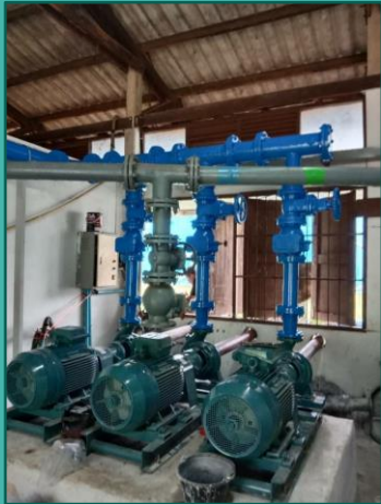
ระบบเครื่องสูบน้ำ สูบส่งขึ้นหอถังสูง
