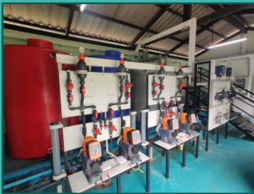
ระบบป้อนเติมเคมีปรับคุณภาพน้ำดิบ
