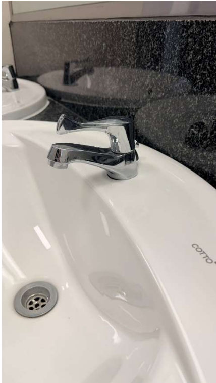
1.4 ก๊อกน้ำที่มีปริมาณการใช้น้ำไม่เกิน 6 ลิตร/นาที
